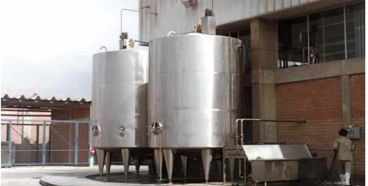
Fotografía 10 Equipos de Purificación AQUA PURIFICACION SYSTEMS
