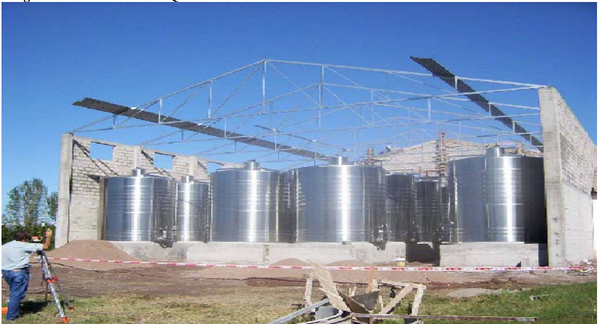
Fotografía 11 SALA DE TANQUES ACERO INOXIDABLE BODEGA ESMERALDA S.A.
